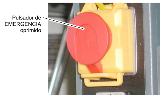
Fig.1-2: Pulsador de EMERGENCIA
