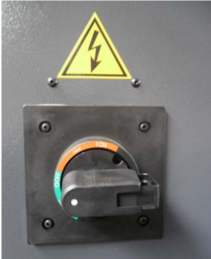
Img. 1-1: Main switch
