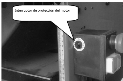
Fig.3: Interruptor de protección del motor
